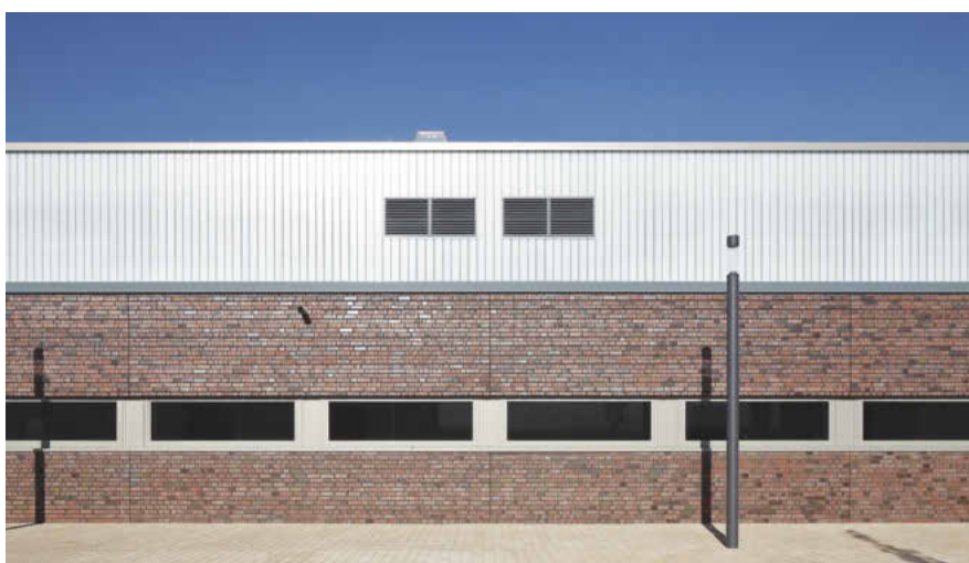
Die Fassade aus Bauprofilglas mit innenliegendem transluzentem Glasgespinst bietet Wärmedämmung und Sonnenschutz zugleich.
